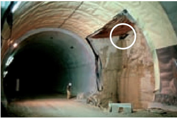
Cavité (dans le cercle) recoupée lors du percement d'un tunnel sur l'autoroute A5 Neuchâtel-Yverdon. En période de crue, plus d'un mètre cube d'eau jaillit par seconde de ce conduit!
